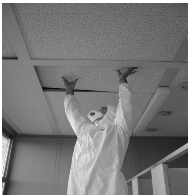
Faux plafond contenant de l'amiante, photo IST
